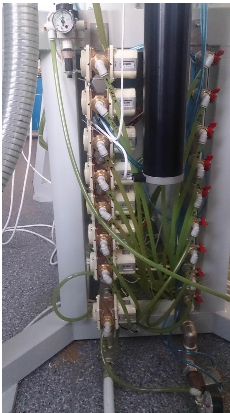
Фото 3 Внешний вид системы охлаждения
